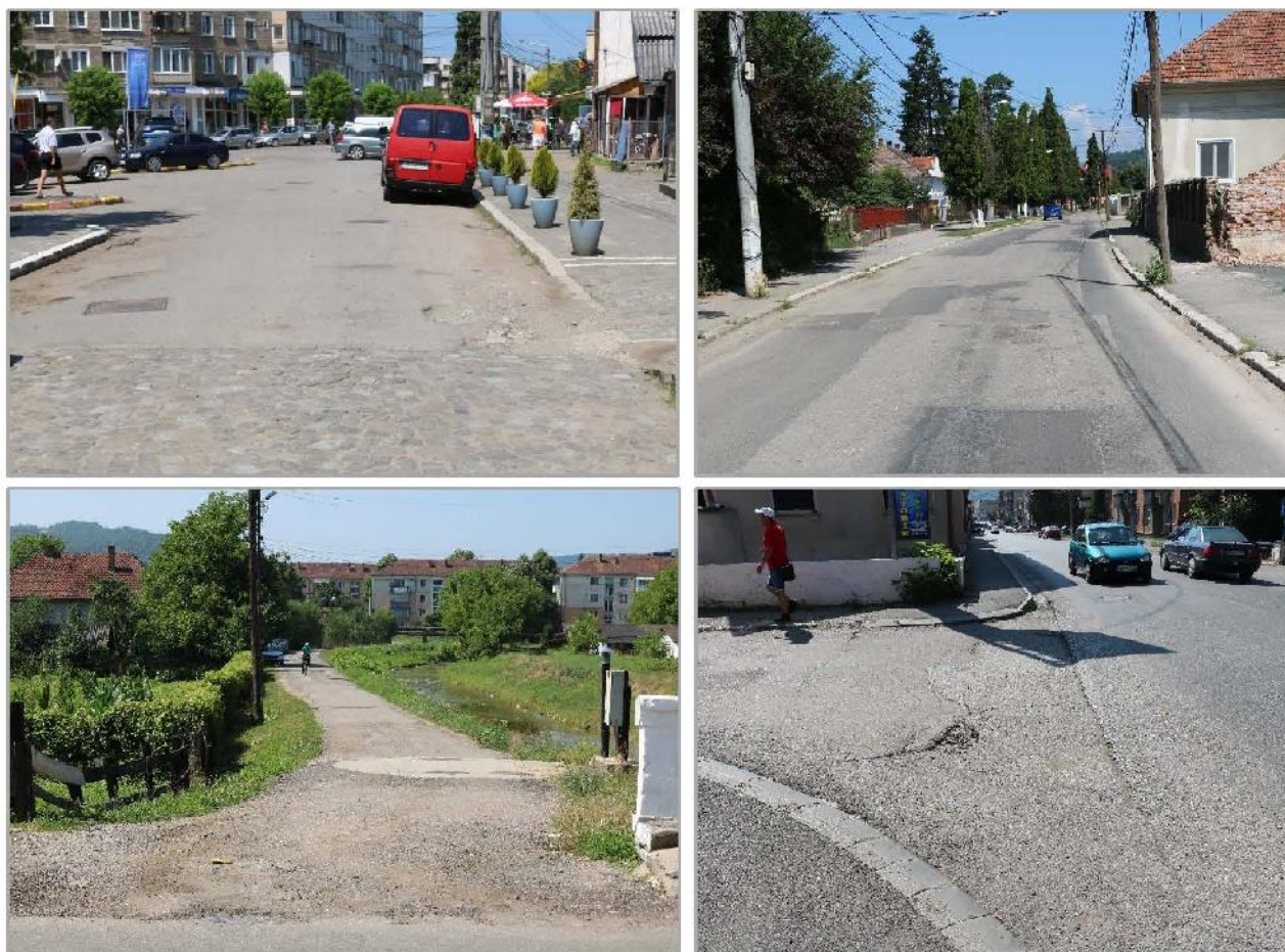
Figura 2.22. Străzi a căror suprafață de rulare se află în stare tehnică proastă (Exemplificare).
